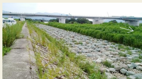
図6 洗堀対策実施後の状況 (R1.8.27 RiMaDIS巡視記録より)
