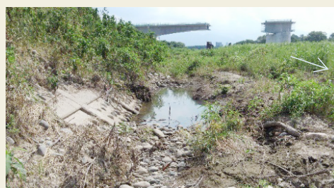
図5 護岸前面洗堀時の状況 (H30.7.24 RiMaDIS巡視記録より)
